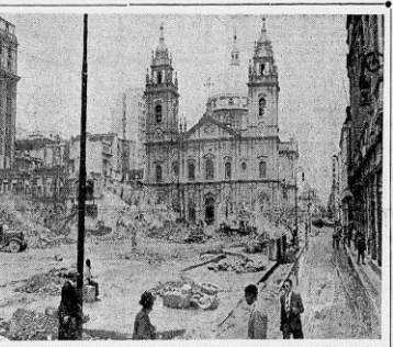
ANDARAES NA AV. PRESIDENTE VARGAS — Fugiente feito esta manhã, da rua Visconde de Itaboraí, nos trabalhos de demolição da Avenida Presidente Vargas. Vê-se a Candelária isolada e, ao longe, a Igreja de São Pedro, que deverá ser demolida de breve. (Clicado na 3.ª página)
